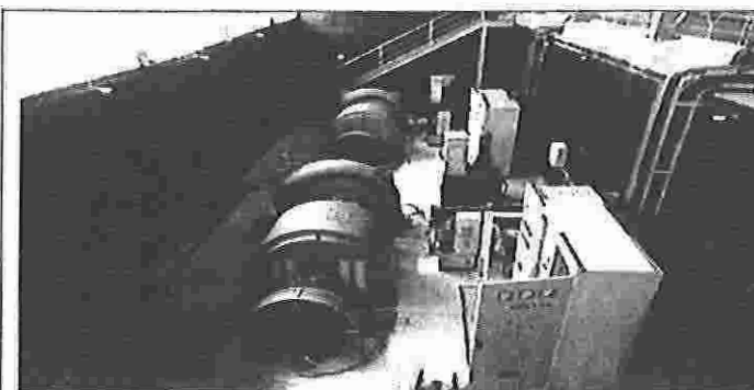
Hình ảnh tổng quan bên trong nhà máy thủy điện Đăk Grét
